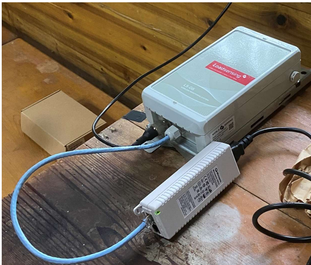
圖 73. 傾斜度計接收器(攝於巨木區管理站)
